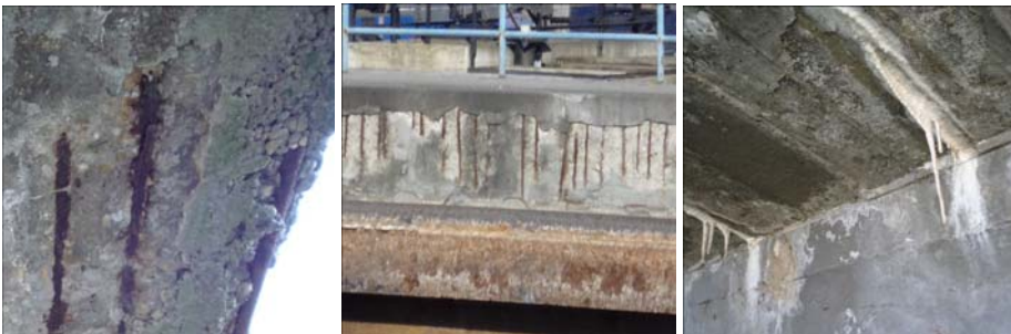
4. ábra. Porózus beton, levált betontakarás, mészkő
